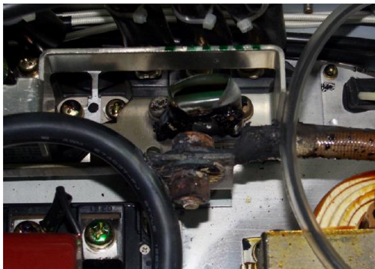
Рис.4. Повреждение силового соединения в результате плохого контакта
